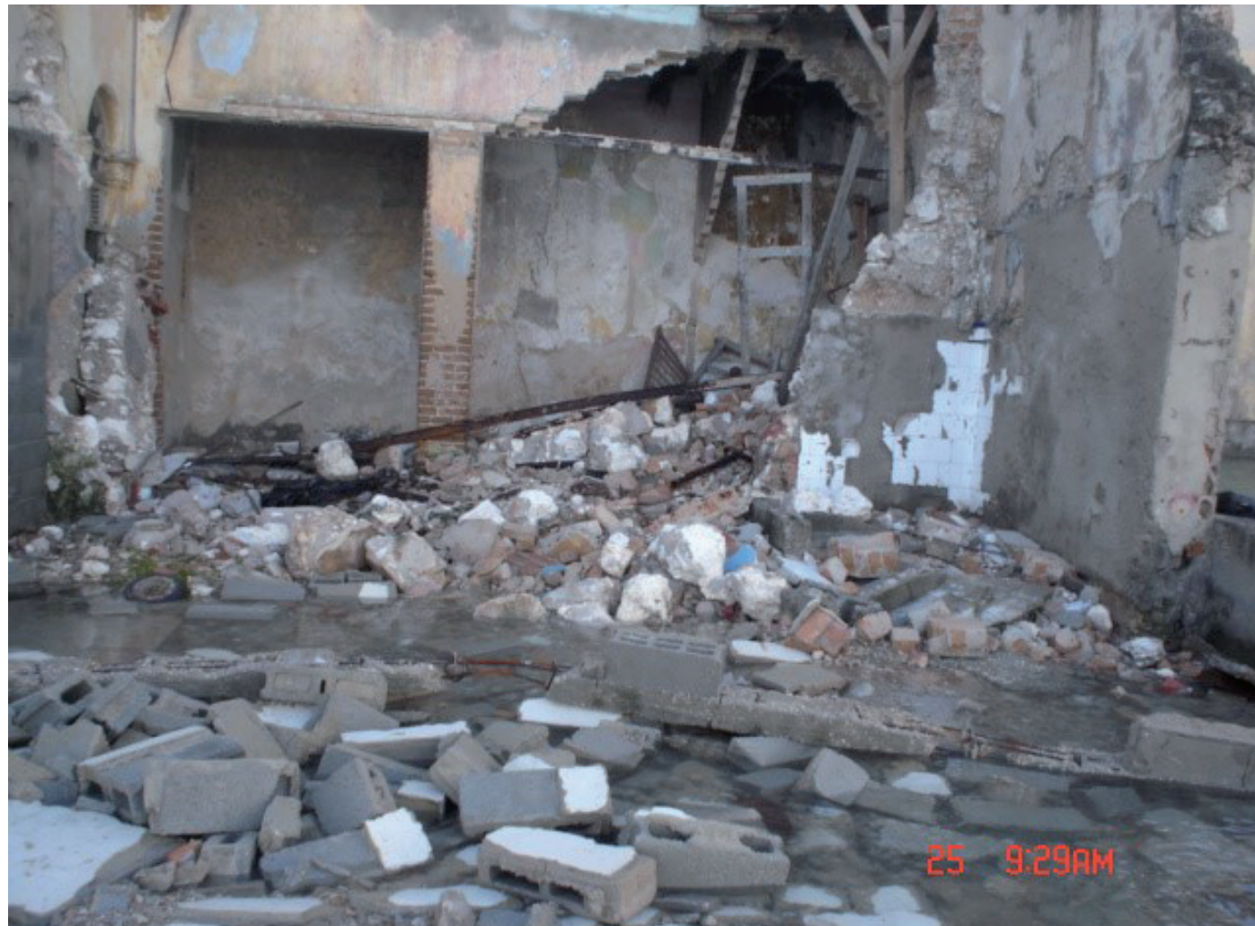
Derrumbe provocado por malas condiciones de la construcción.
